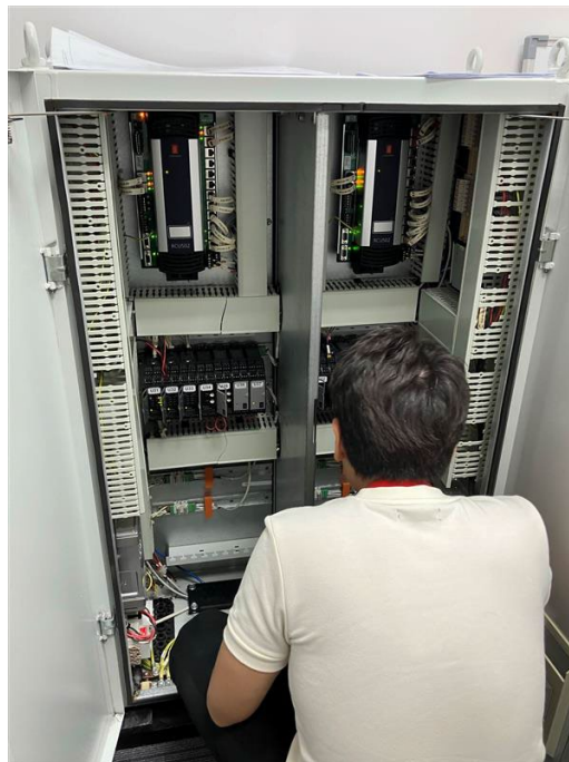
RCUキャビネット内
